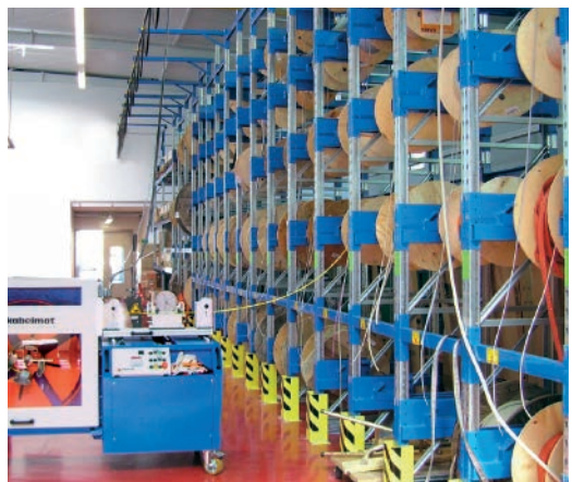
SYSTEM LAGROL /ABROL – rozwiązania idealne dla Centrum logistycznego sieci hurtowni, zakładów produkcyjnych. HELUKABEL Polska dostarczył już kilkanaście takich rozwiązań do swoich Partnerów na terenie całej Polski.
